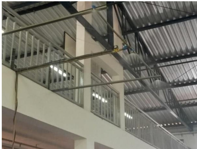
Figura A. 4: Três bocais em funcionamento
