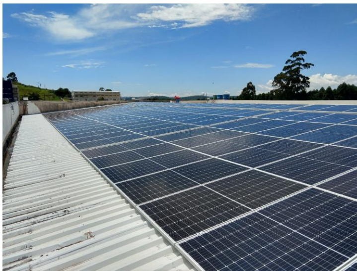
Figura 6 — Módulos fotovoltaicos instalados no prédio F
