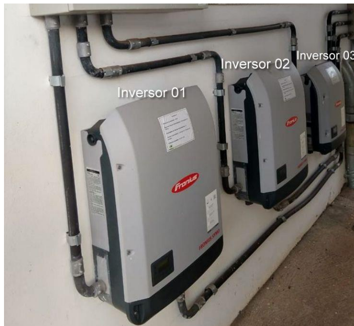
Figura 9 — Inversores do Prédio G
