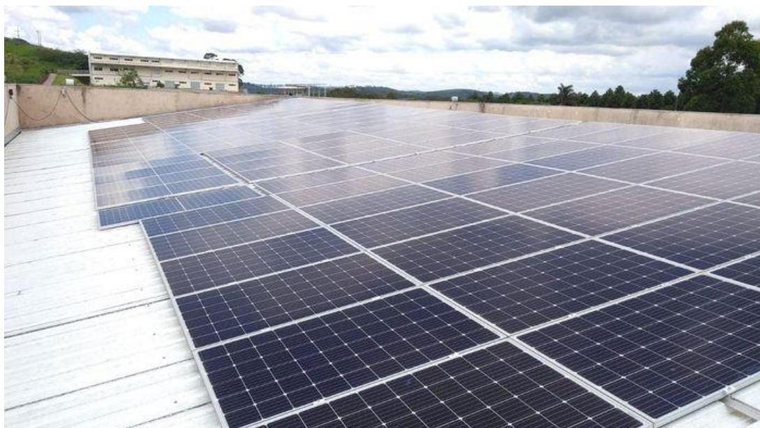
Figura 8 — Módulos fotovoltaicos instalados no prédio G
