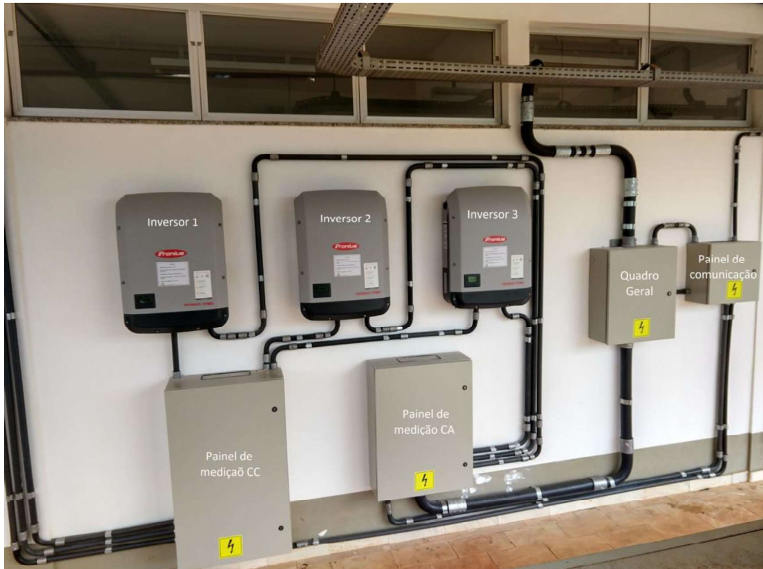
Figura 11 — Sistema de automação e inversores do Prédio F
