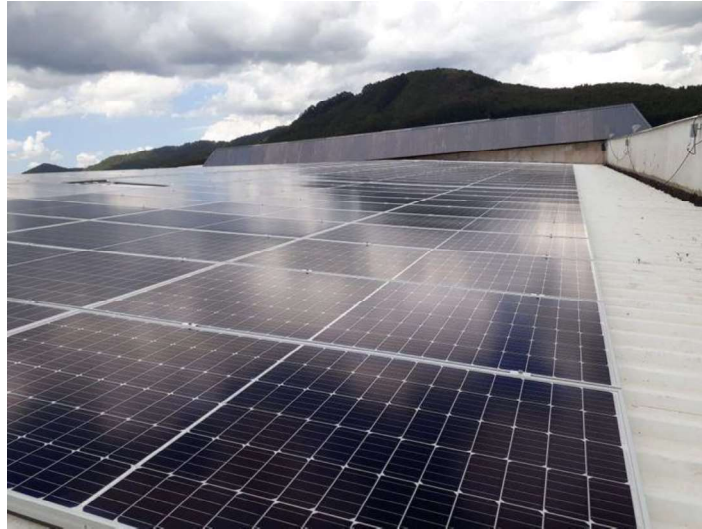
Figura 8 — Painéis Fotovoltaicos Instalados no Prédio F
