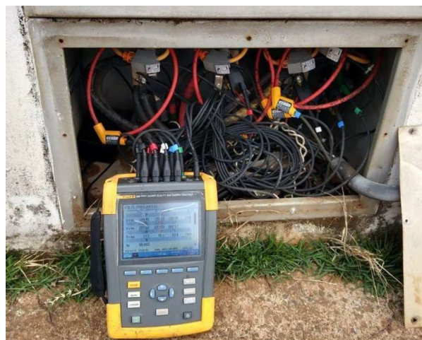
Figura 21 — Analisador de energia instalado no painel de entrada
