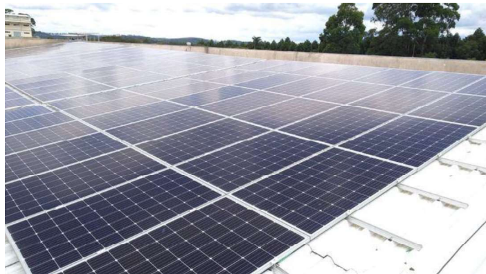
Figura 9 — Painéis Fotovoltaicos Instalados no Prédio G
