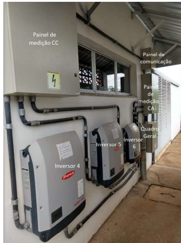
Figura 12 — Sistema de automação e inversores do Prédio G
