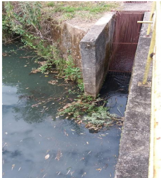
Figura 6- Captação Ribeirão da Serra.
