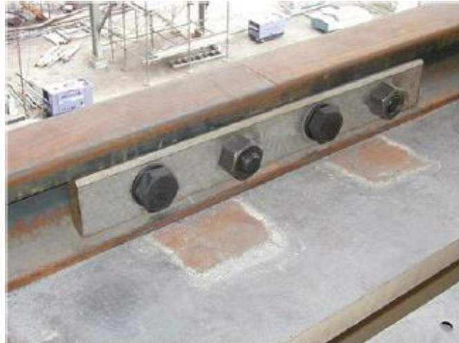
Figura 3.17 - Aspecto final do trilho de guindaste emendado com uma liga inoxidável Fe-Mn-Si-Cr-Ni com EMF.
